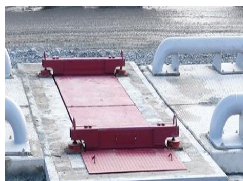
Исполнение ГПУ над поверхностью
