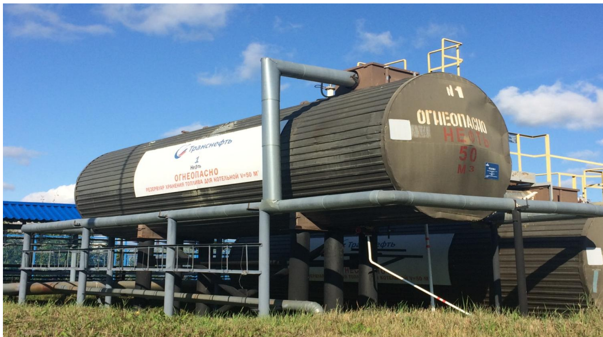
Рисунок 1 - Общий вид резервуаров стальных горизонтальных цилиндрических РГС-50 (45+5)
