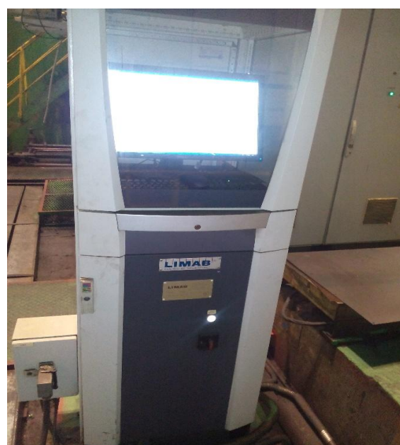
Рисунок 2 - Общий вид шкафа (пульт) управления с ПК оператора
