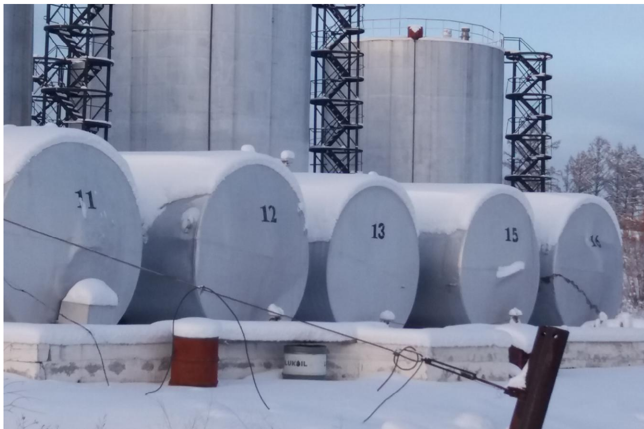
Рисунок 2 - Общий вид резервуаров РГС-25, РГС-60
