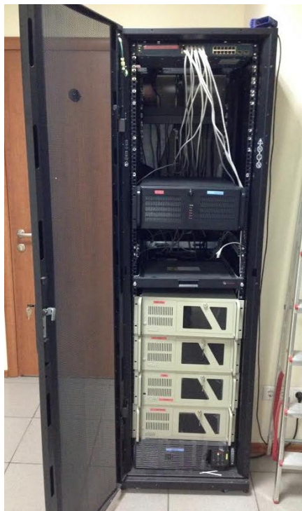
Рисунок 1 - Общий вид оборудования с открытой дверью
