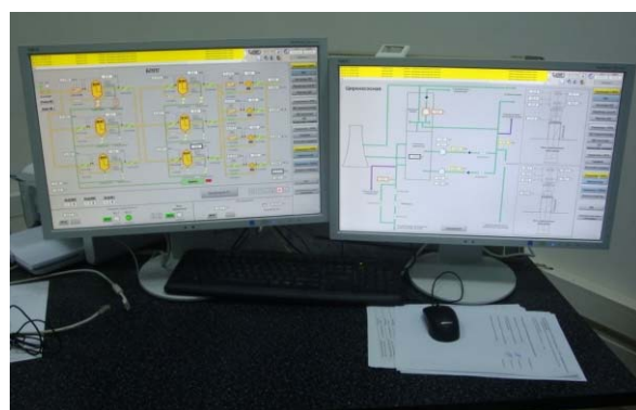
в) АРМ инженера ПТК ТЕКОН
