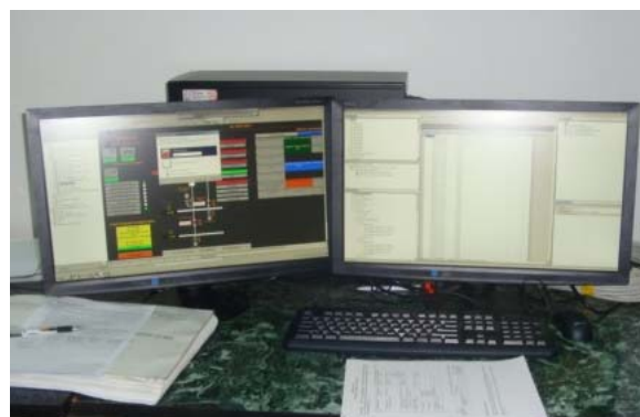
б) АРМ дежурного инженера АСУ
