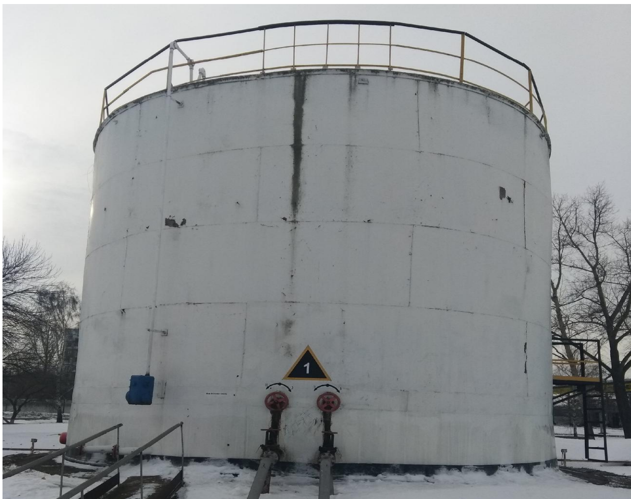
Рисунок 2 – Общий вид резервуара стального вертикального цилиндрического РВСП-400
