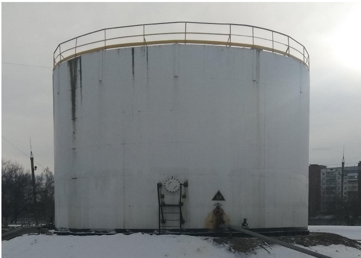
Рисунок 1 – Общий вид резервуара стального вертикального цилиндрического РВСП-1000
