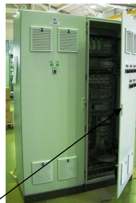
Общий вид шкафа ШУСР
