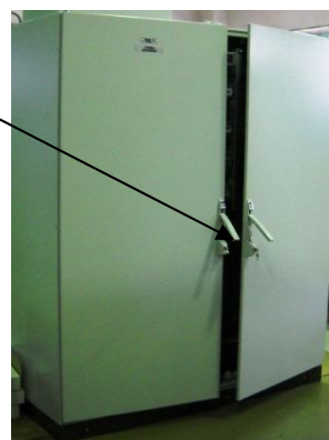
Общий вид стойки системной СС
