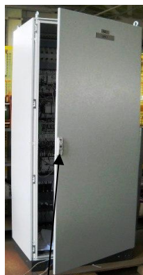
Общий вид шкафа ШУС
