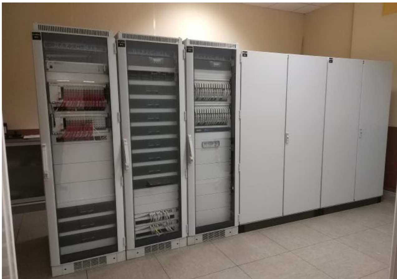
Рисунок 2 – Оборудование верхнего и нижнего уровней системы
