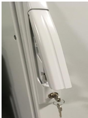
Рисунок 3 – Защита от несанкционированного доступа с помощью замка, установленного в ручке шкафа ИВК
