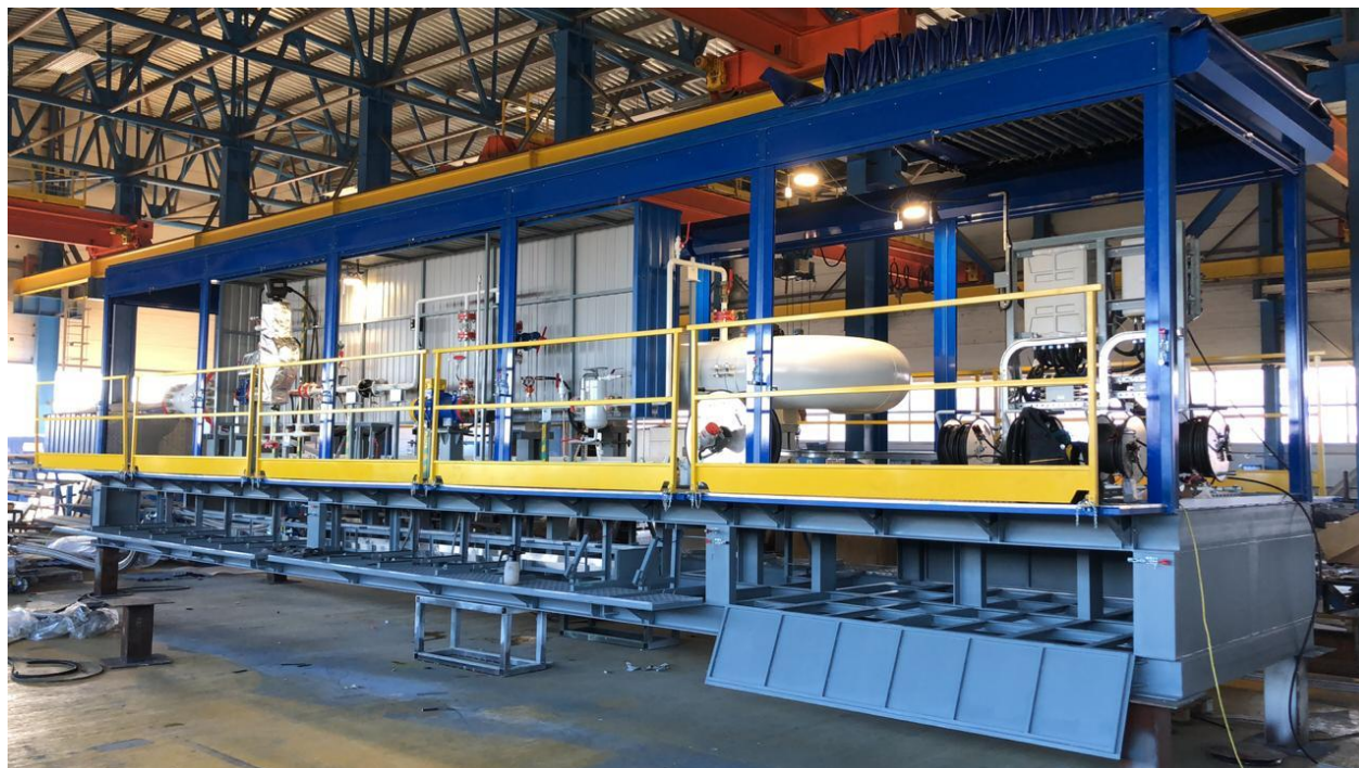
Рисунок 1 – Общий вид установки
