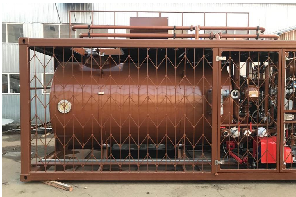
Рисунок 1 - Общий вид резервуаров Рпр-10
