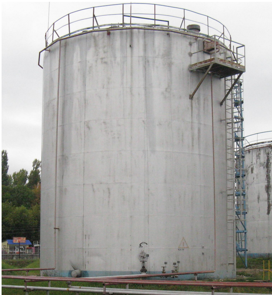
Рисунок 1 - Резервуар стальной вертикальный цилиндрический РВС-1000
