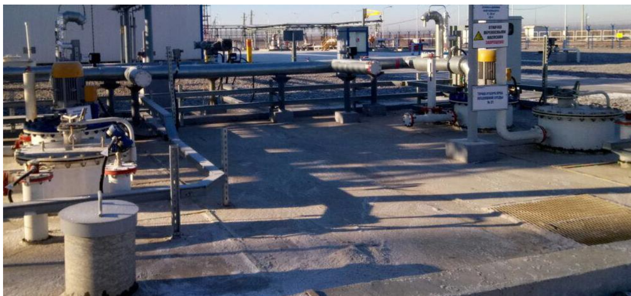
Рисунок 1 - Общий вид места установки резервуаров стальных горизонтальных цилиндрических РГС-20 зав. №№ 59077, 59078
