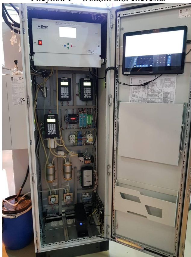
Рисунок 2 – Вид внутри шкафа газоаналитической части системы
