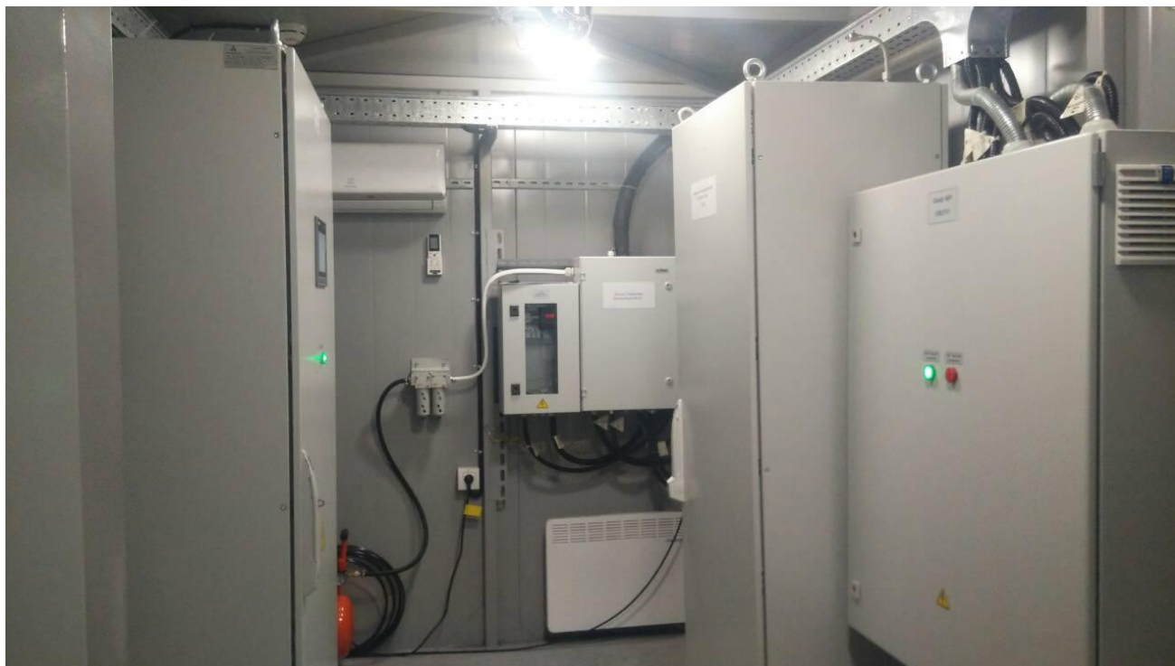
Рисунок 2 – Вид внутри контейнера
