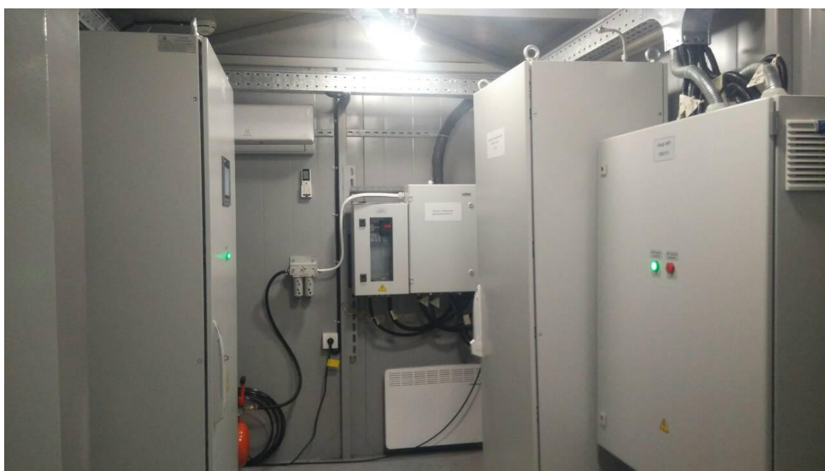
Рисунок 2 – Вид внутри контейнера
