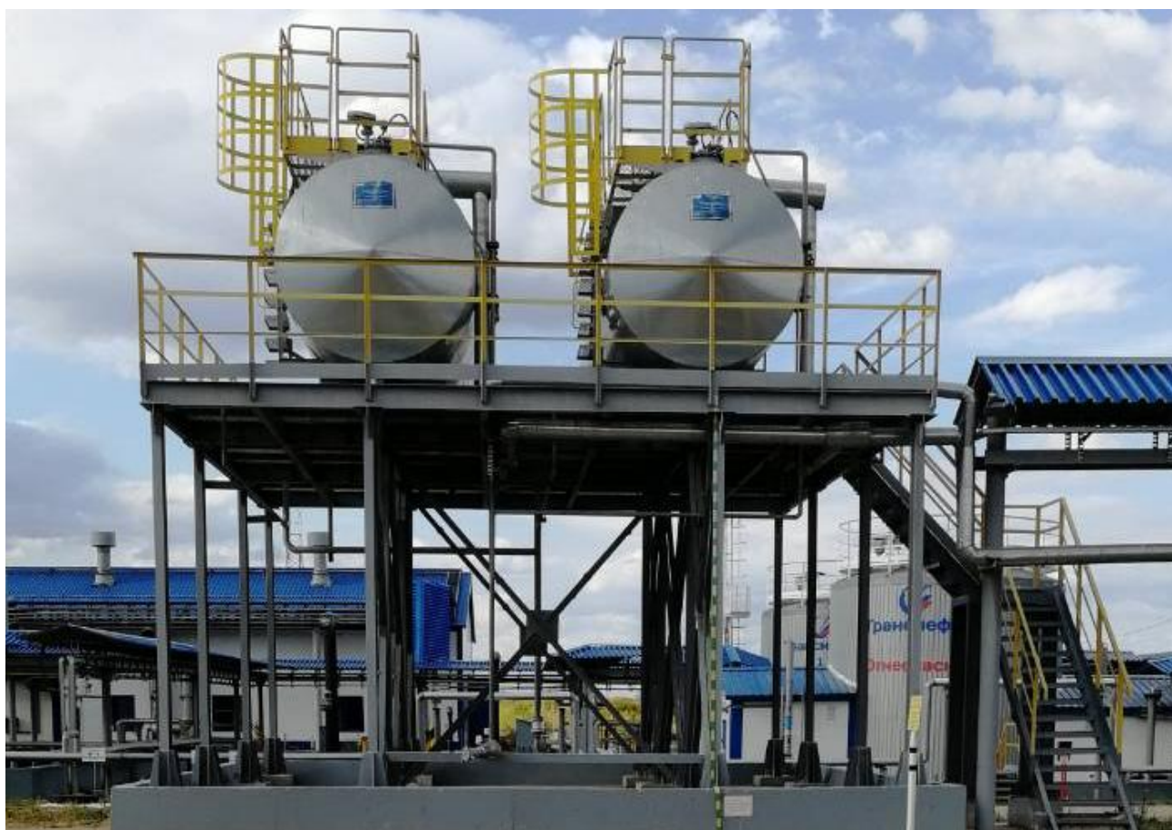
Рисунок 2 - Общий вид резервуаров РГС-20 №№ 275, 276
