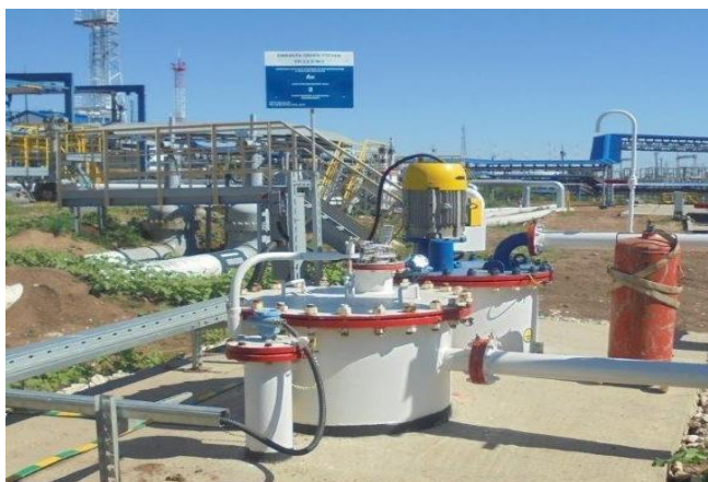
Рисунок 2 - Общий вид места установки резервуара РГС-12,5 № 59060
