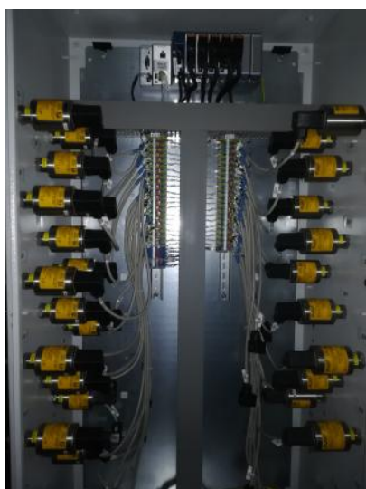
Рисунок 3 - Шкаф датчиков давления
