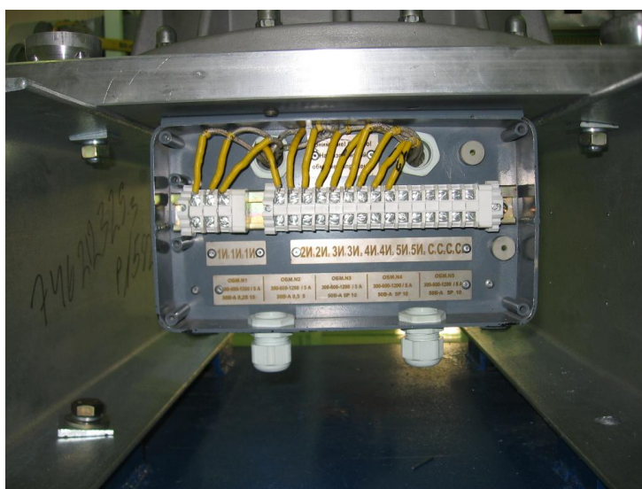
Рисунок 3 - Общий вид клеммной коробки трансформатора
