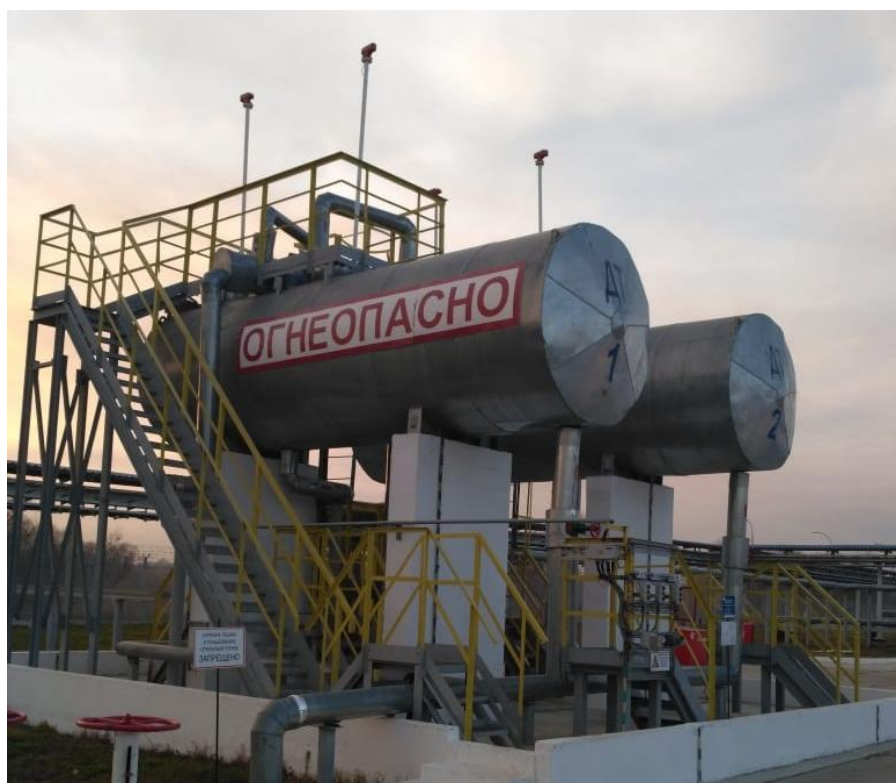
Рисунок 1 - Общий вид резервуаров РГС-20 № 0067-2012, № 0068-2012
