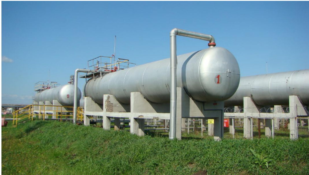
Рисунок 1 - Общий вид резервуаров стальных горизонтальных цилиндрических РГС-50
