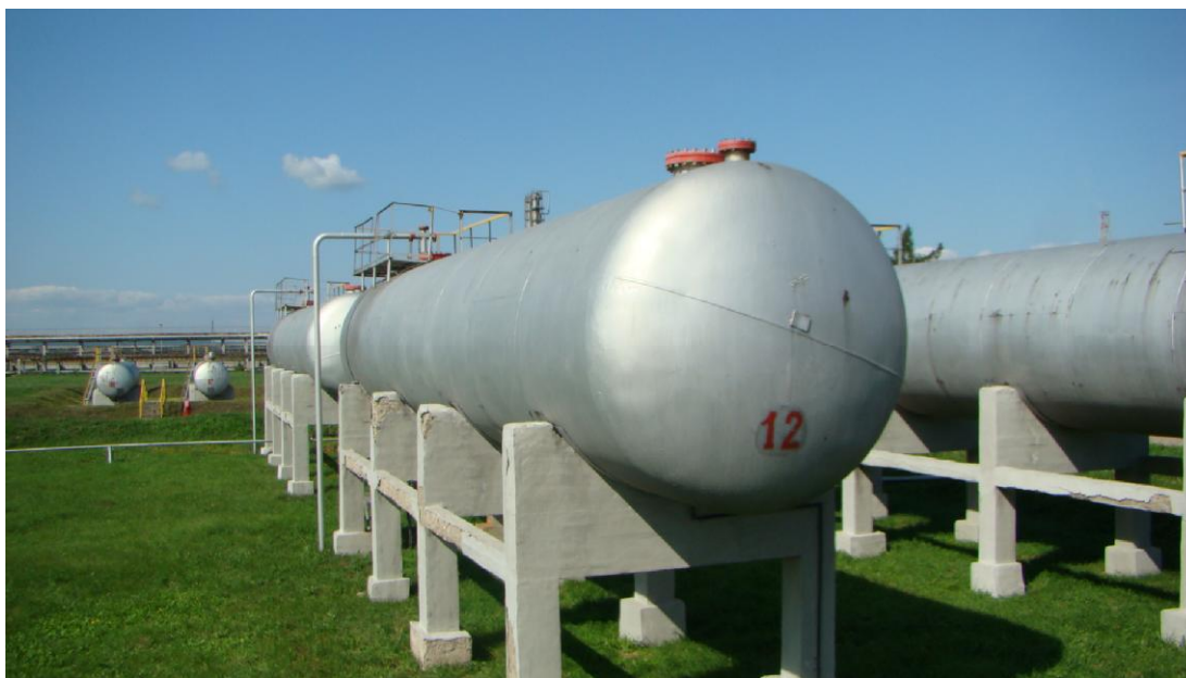
Рисунок 1 - Общий вид резервуаров стальных горизонтальных цилиндрических РГС-112
