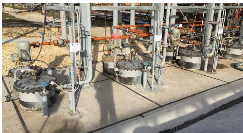
Рисунок 2 - Общий вид места установки резервуара стального горизонтального цилиндрического РГС-8/ЕП-8
