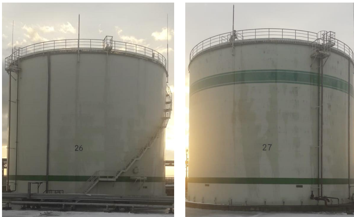
Рисунок 2 - Общий вид резервуаров вертикальных стальных цилиндрических РВС-7500 зав. №№ 26, 27
