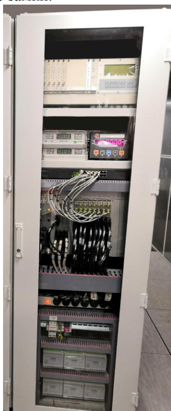
Рисунок 1 - Шкаф измерительного оборудования
