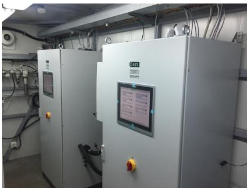
Рисунок 2 - Вид газоаналитических шкафов ETL Multigas внутри контейнера
