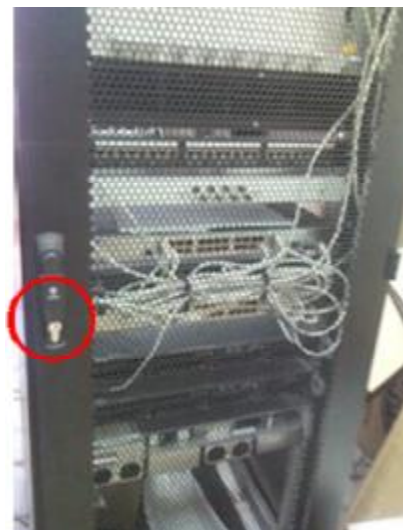
Рисунок 2 - Общий вид оборудования с закрытой дверью
