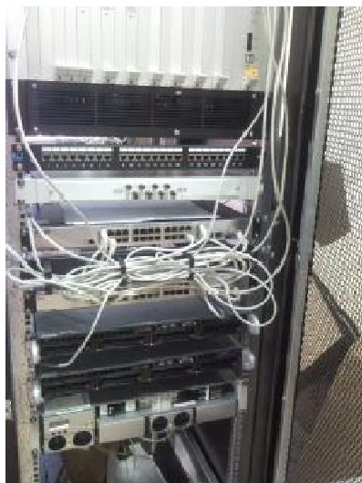
Рисунок 1 - Общий вид оборудования с открытой дверью
