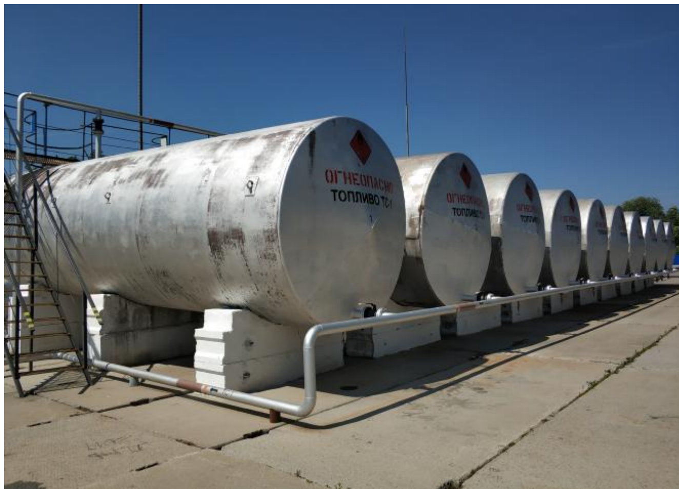
Рисунок 1 – Общий вид резервуаров РГС-50
