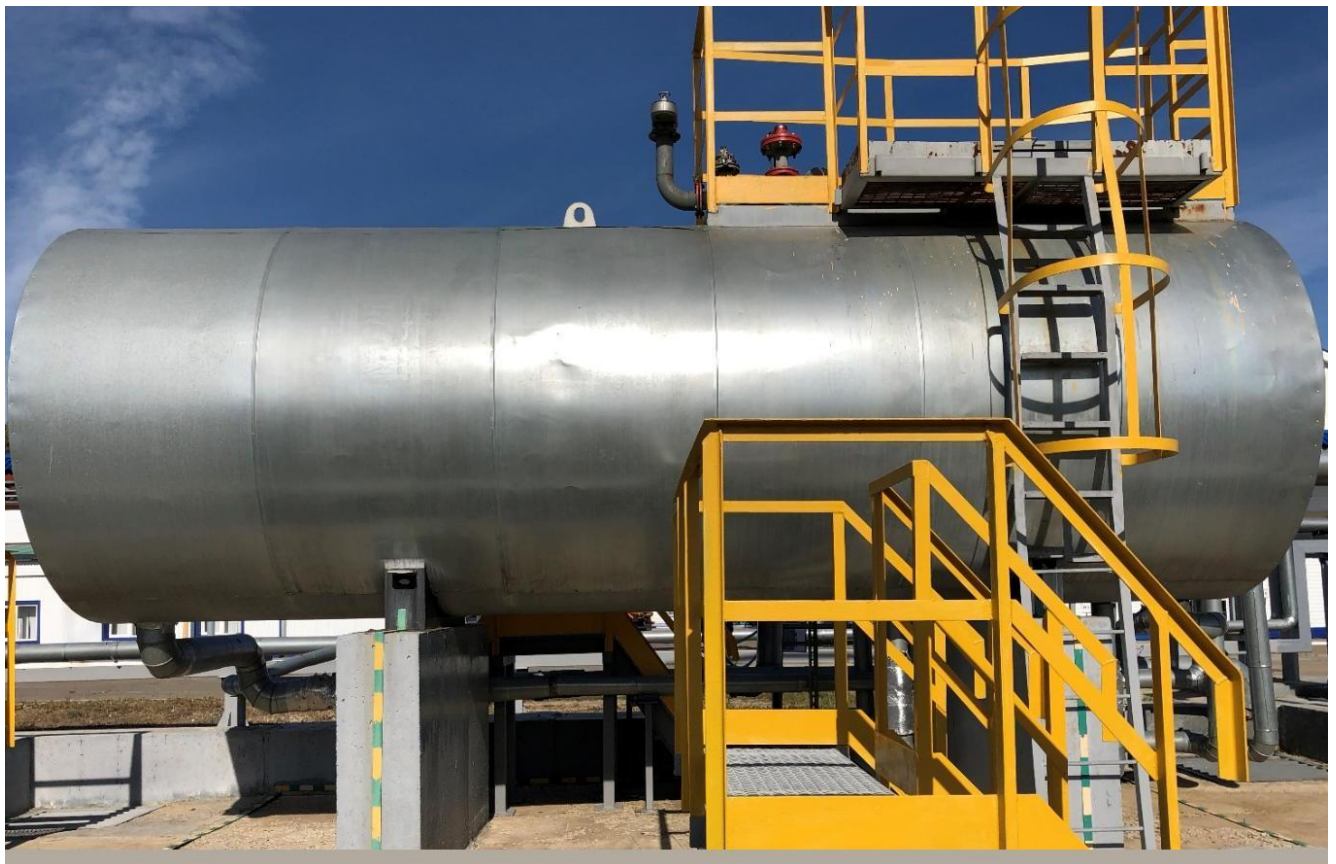
Рисунок 1 - Общий вид резервуаров стальных горизонтальных цилиндрических РГС-20
