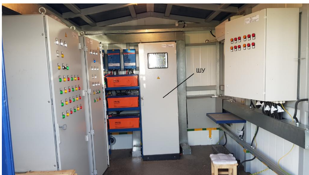
Рисунок 2 – Общий вид смонтированного шкафа управления, содержащего СОИ системы в составе аппаратного блока ИУ-реципиента
