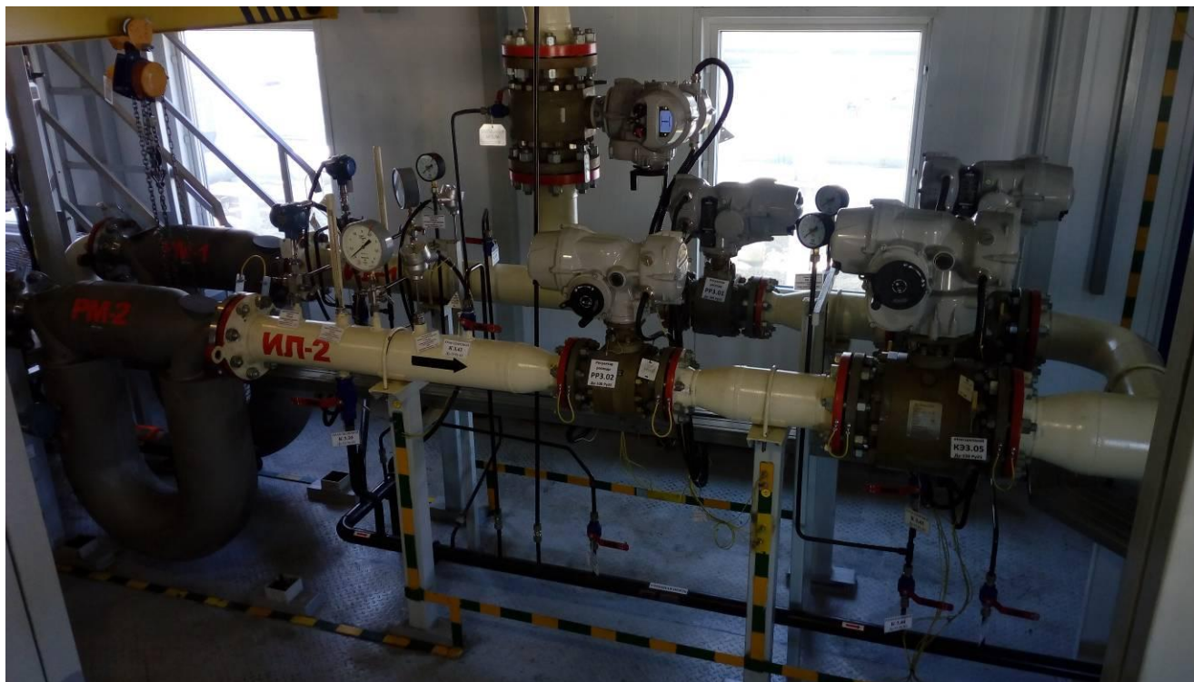
Рисунок 1 – Общий вид СИКН
