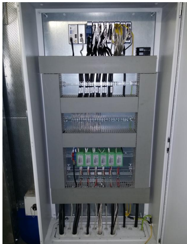
Рисунок 4 - Шкаф температурных параметров
