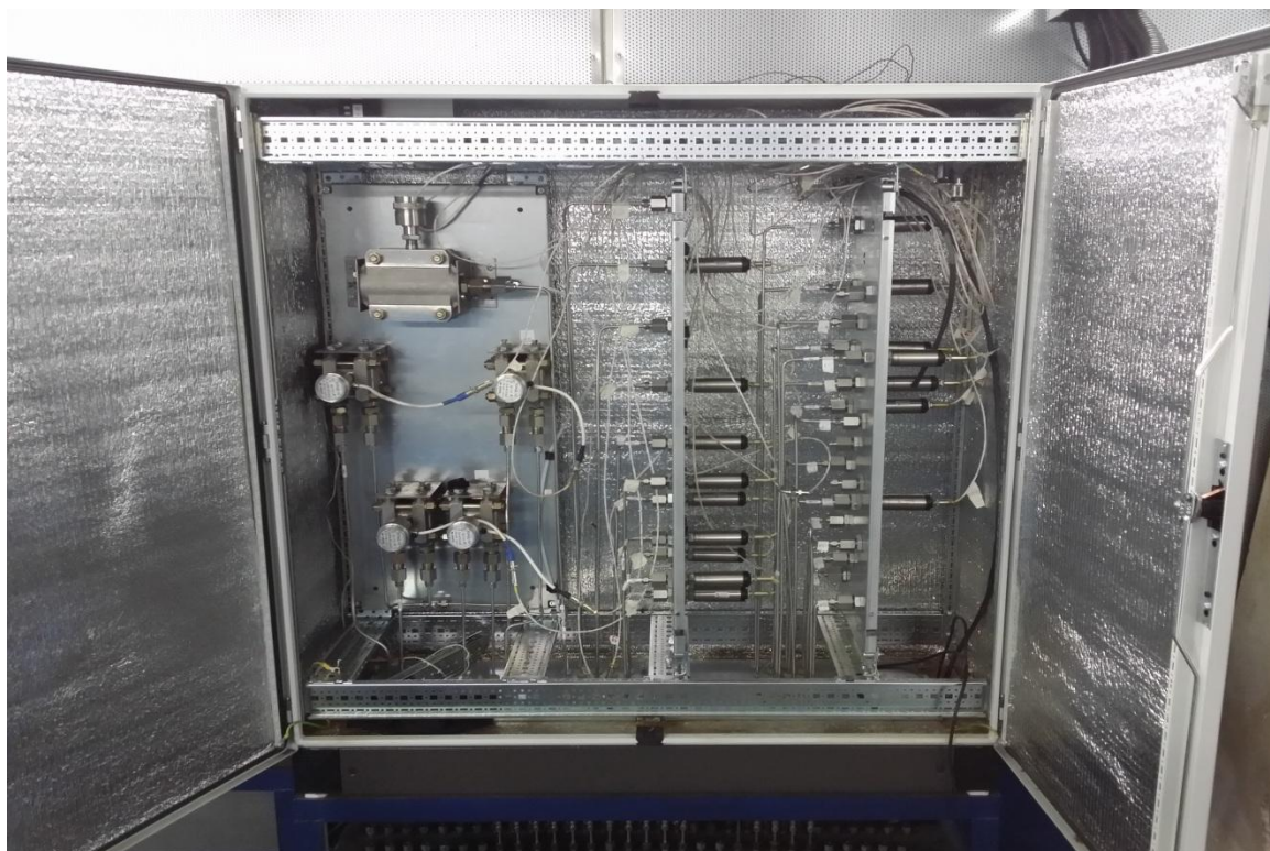
Рисунок 5 - Шкаф датчиков давления
