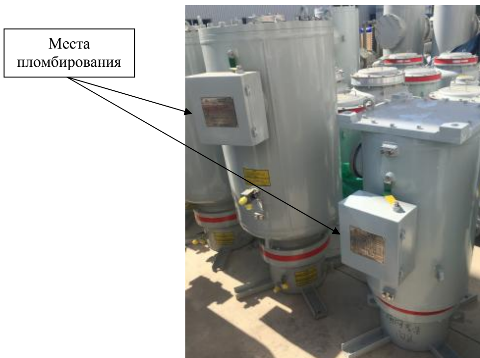
Рисунок 1 - Общий вид трансформаторов с указанием мест пломбирования от несанкционированного доступа
