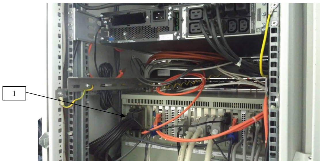
1 – плата последовательного ввода CP-18U-I Рисунок 4 – Шкаф ША (вид с тыльной стороны)
