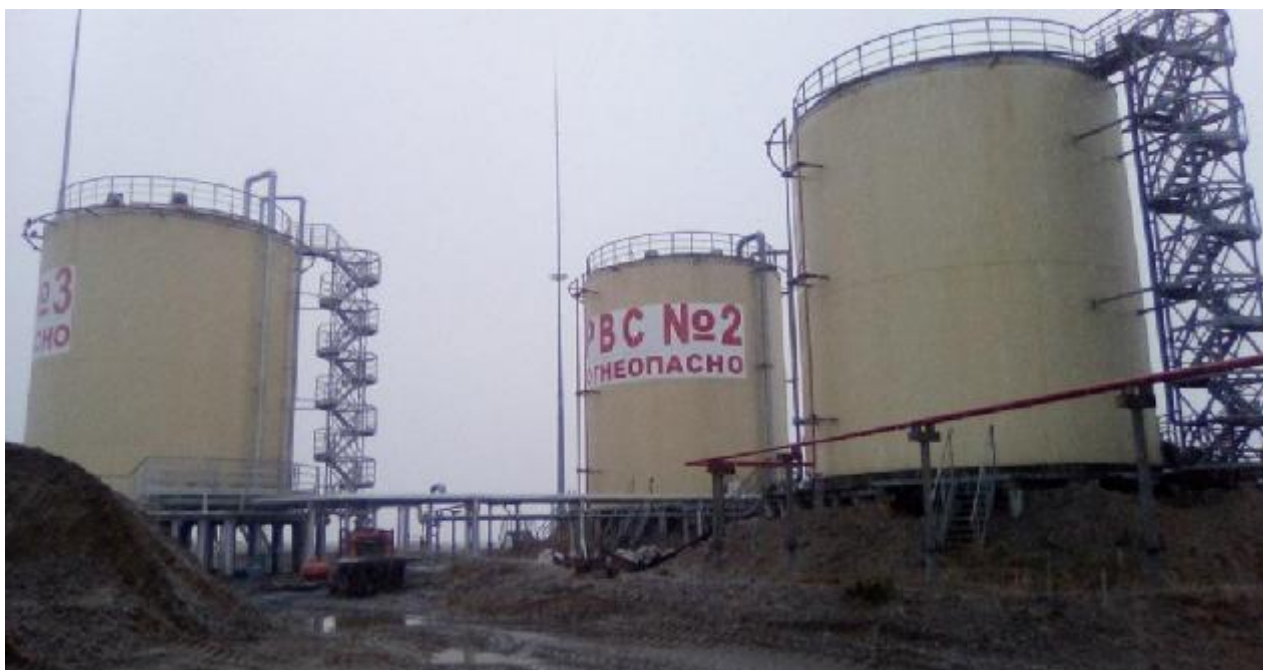
Рисунок 1 – Общий вид резервуаров вертикальных стальных цилиндрических теплоизолированных РВС-1000
