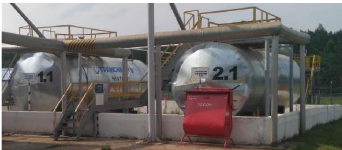
Рисунок 1 – Общий вид резервуаров РГС-20 (17+3) зав. №№ 6387 14/36, 6387 15/36
