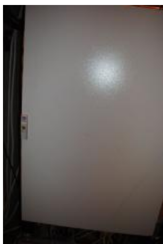
Рисунок 3 – Шкаф термостанции АИИС
