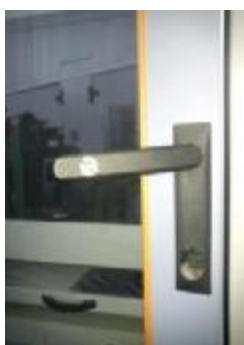
Рисунок 15 – Внешний вид замка на дверце стойки управления
