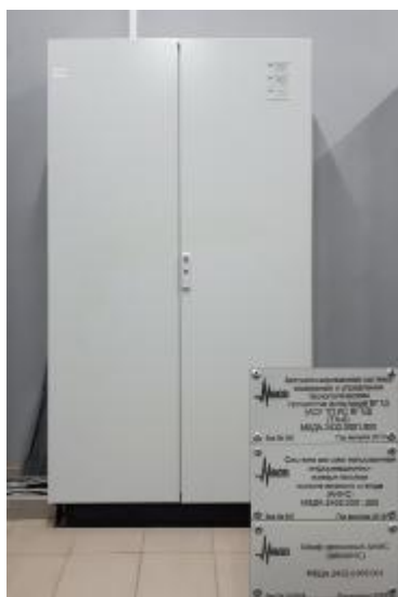
Рисунок 3 – Шкаф кроссовый АИИС. Вид внешний
