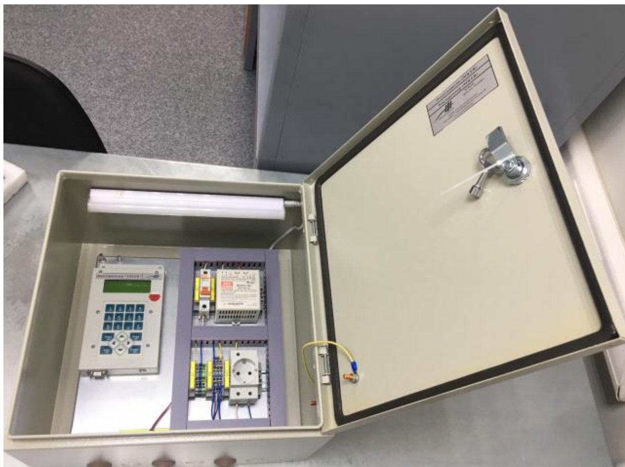
а) Измерительный модуль кислородомера в монтажном шкафу
