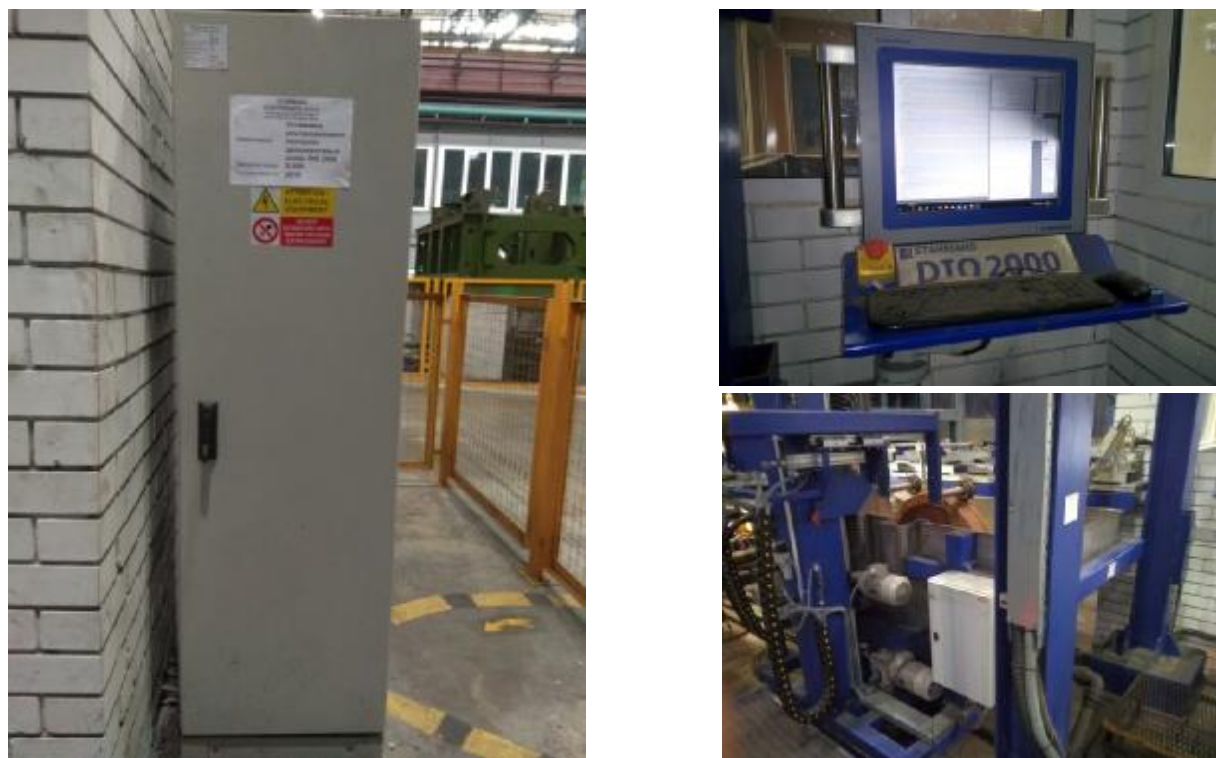
Рисунок 1 – Общий вид установки
