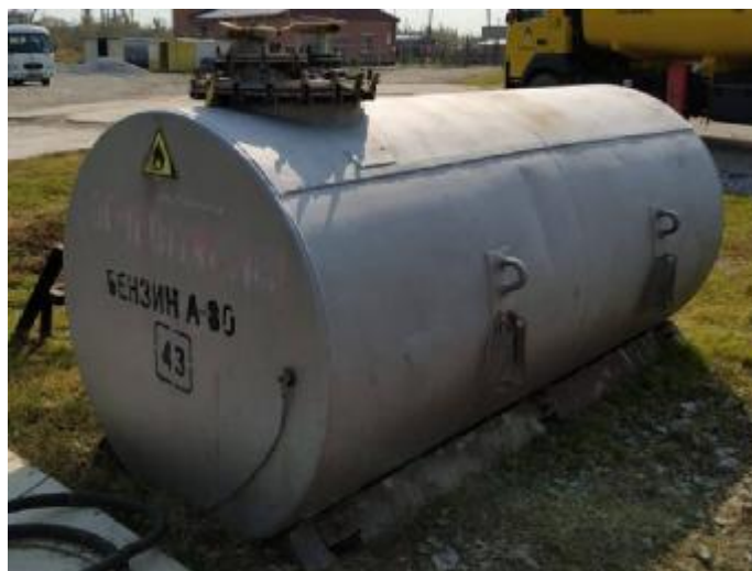
Рисунок 2 – Общий вид резервуаров стальных горизонтальных цилиндрических РГС-4
