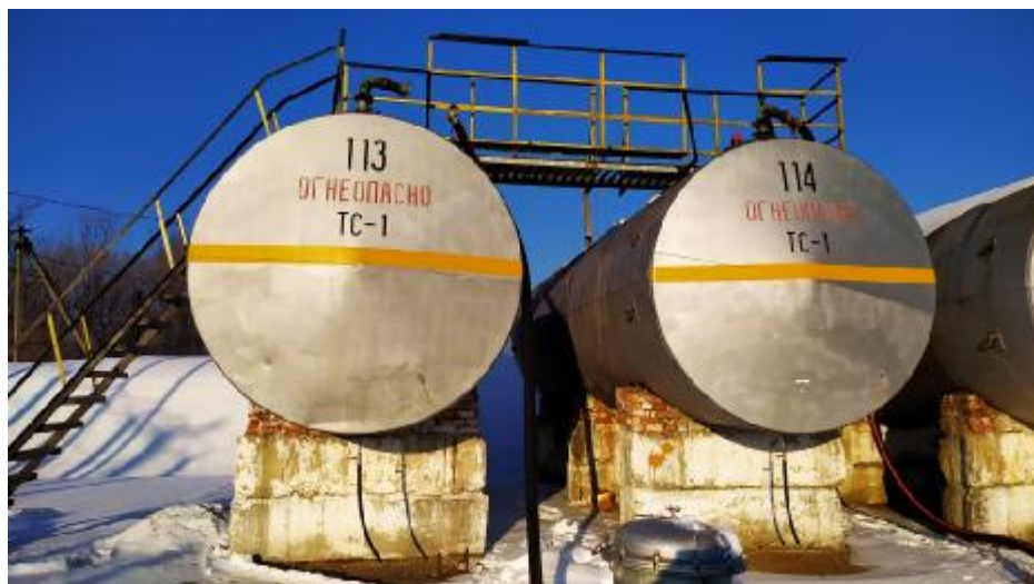
Рисунок 1 – Общий вид резервуаров стальных горизонтальных цилиндрических РГС-50
