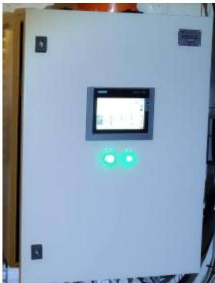
Рисунок 6 – Общий вид контроллерного шкафа ССОД
