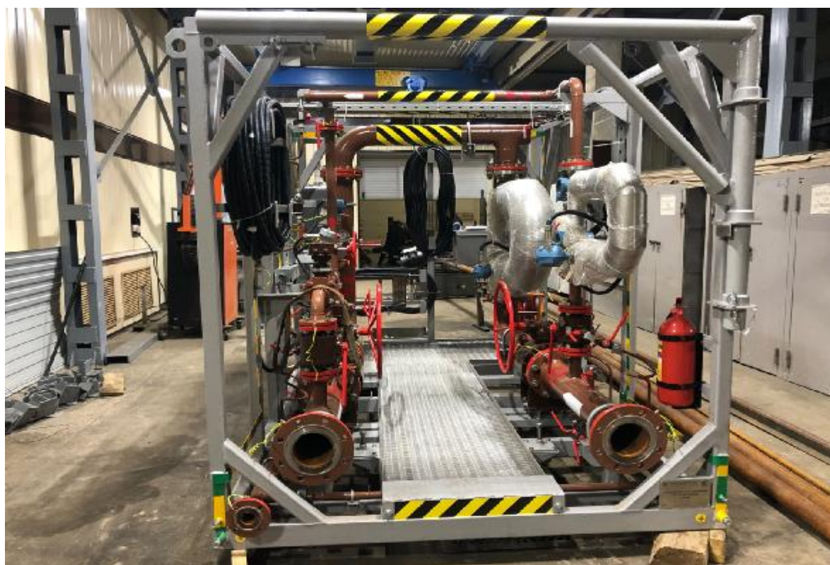
Рисунок 2 – Общий вид установки
