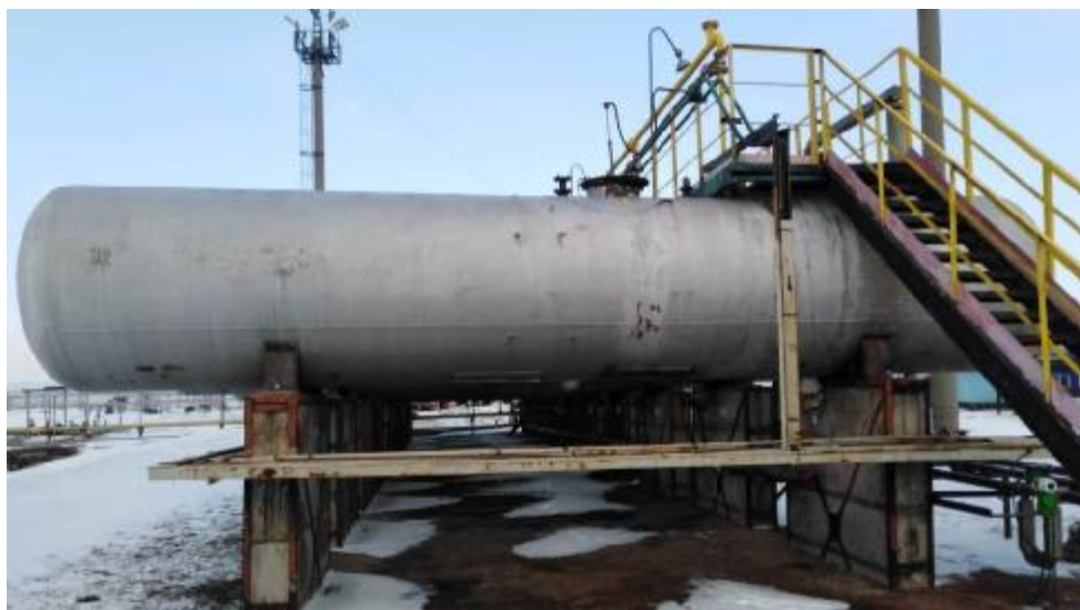
Рисунок 1 – Общий вид резервуаров стальных горизонтальных цилиндрических РГС-32
