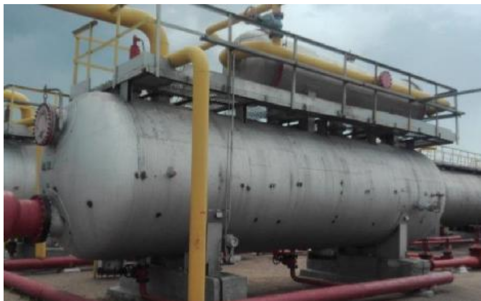
Рисунок 2 – Общий вид резервуаров стальных горизонтальных цилиндрических РГС-50
