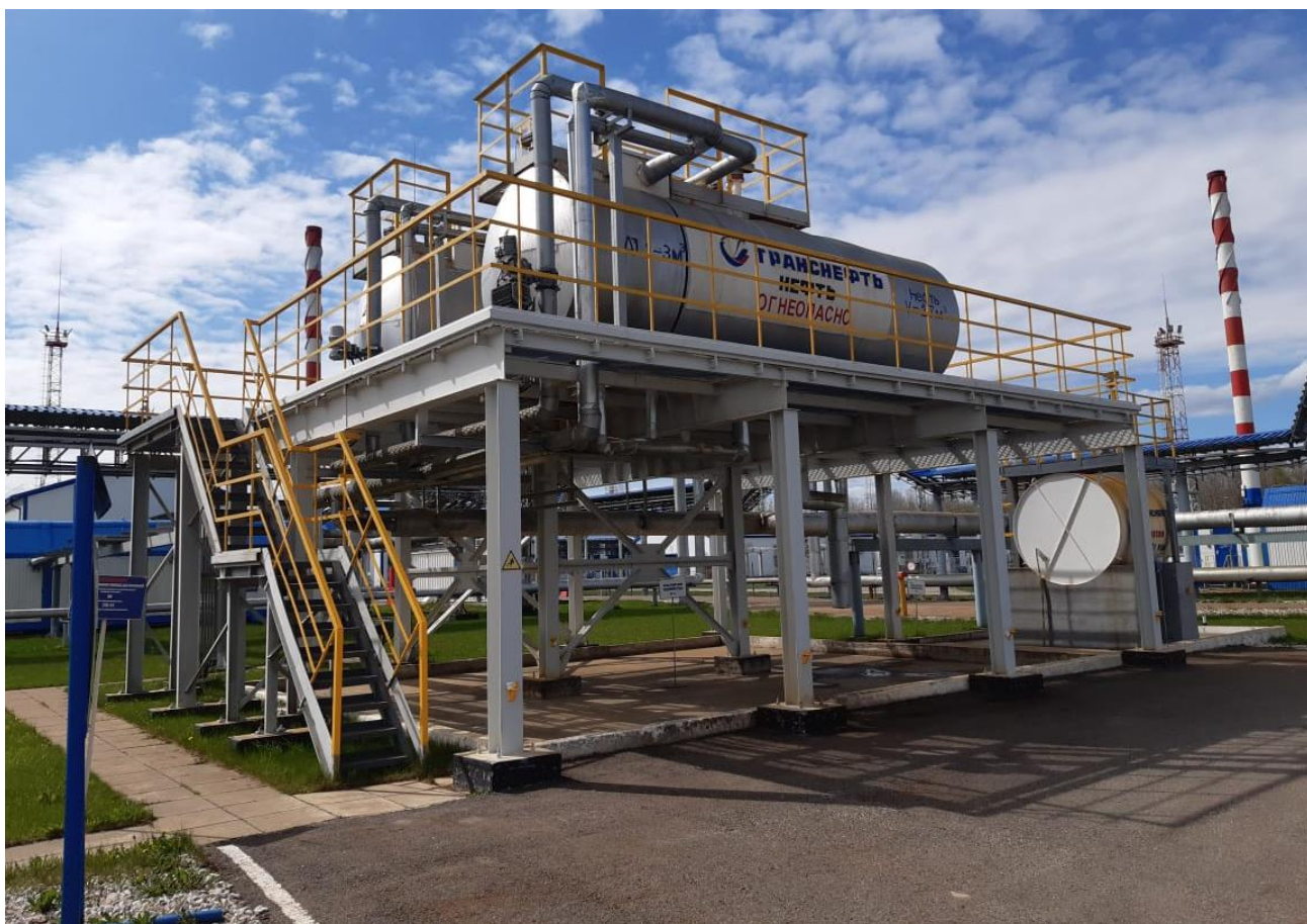
Рисунок 1 – Общий вид резервуаров РГС-20
