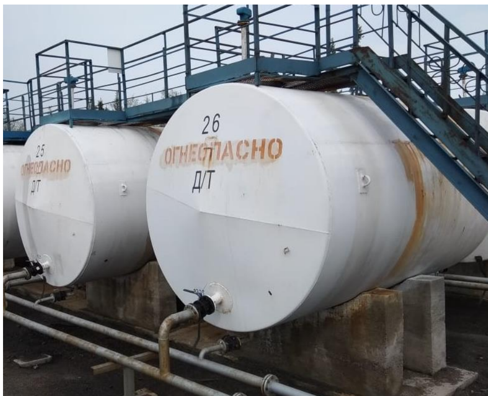
Рисунок 1 – Общий вид резервуаров РГС-25
